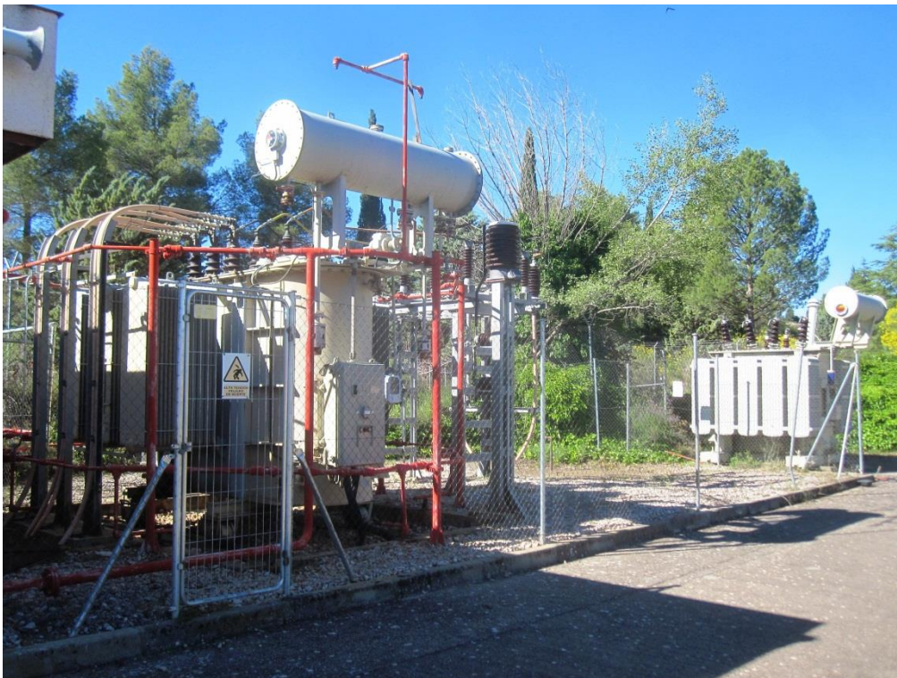
Ilustración 1. Situación física transformadores de potencia (ST1AR y ET1A1)
