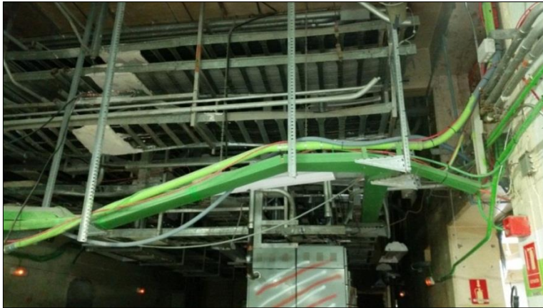
Fotografías 6 y 7. Estado actual sala baterías pl. intermedia EAD
