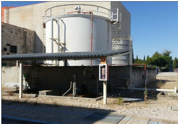
Fotografías 13, 14 y 15. Estado actual tanque gasoil GO-5 y equipamiento asociado
