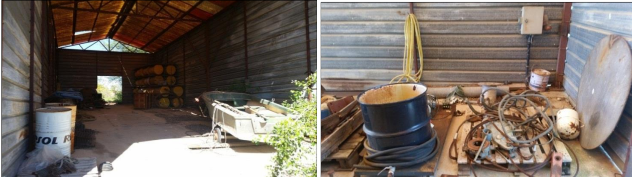
Fotografía 32 y 33. Residuos convencionales en interior a retirar
