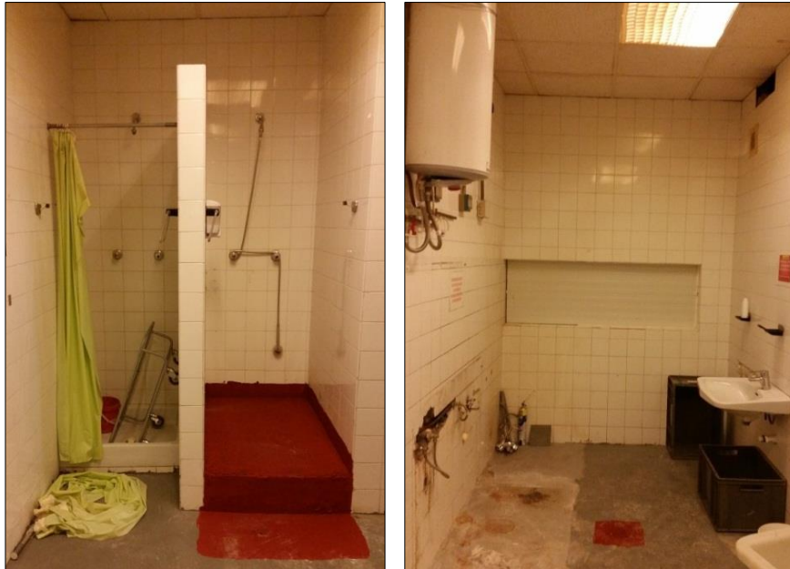
Fotografías 57 y 58. Estado actual zona descontaminación
