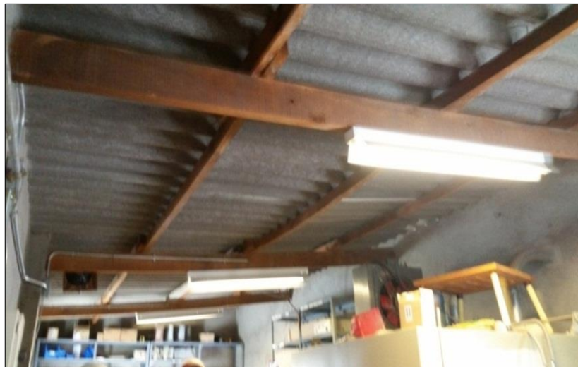
Fotografías 18, 19 y 20. Estado actual edificio taller eléctrico
