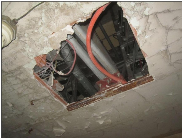
Fotografía 8. Falso techo y bandejas eléctricas antigua Sala de Baterías Tren B
