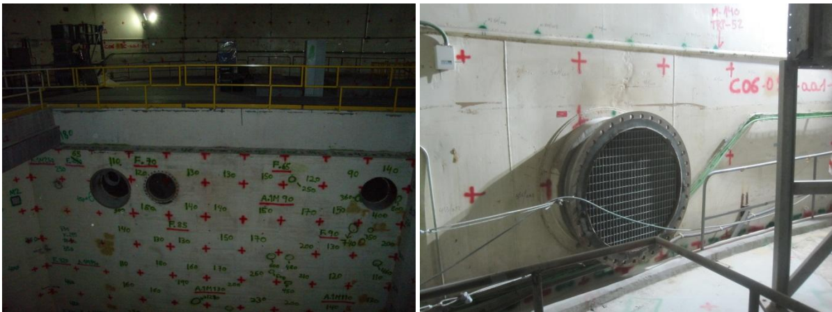
Figura 19. Pasos de ventilación
