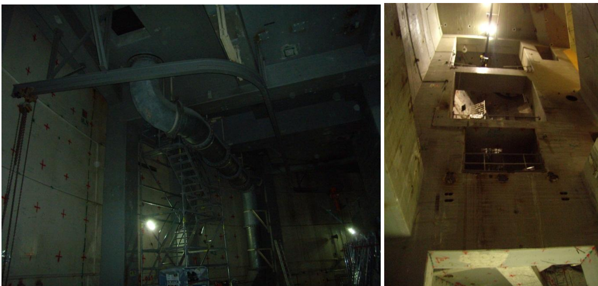
Figura 5. Polipastos en 604 y 621 Contención
