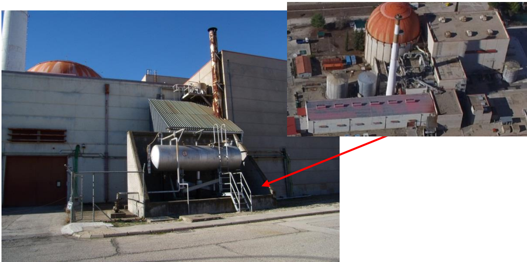
Figura 6. Almacén 1 de residuos. Caldera auxiliar y tanque de gas-oil
