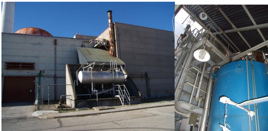
Figura 9. Caldera auxiliar y tanque de gasoil
