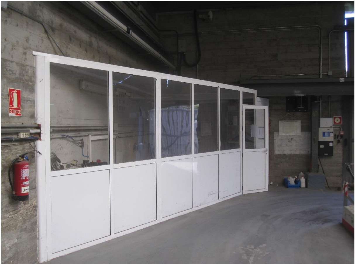
Figura 6 – Sala de operación.
