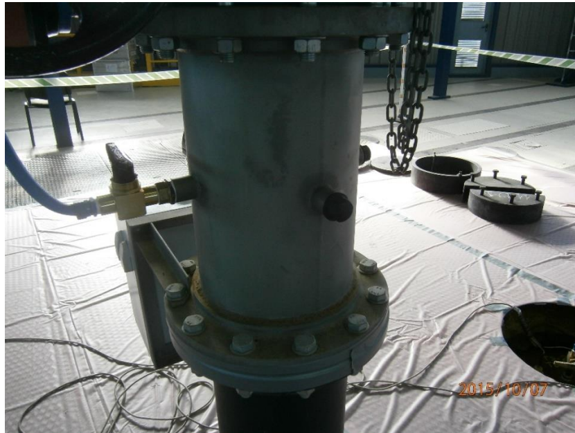
Foto 11. Penetración de venteo F4M18. Tres posibles salidas de fuga controlada al sistema de ventilación, que aloja el filtro HEPA (sistema de extracción). Las tres salidas de las penetraciones frontera están cerradas con tapones roscados macho de 1" de PVC.
