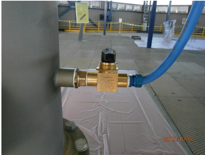
Foto 13. Salida de fuga controlada del sistema de ventilación (filtros HEPA). Fase de despresurización.
