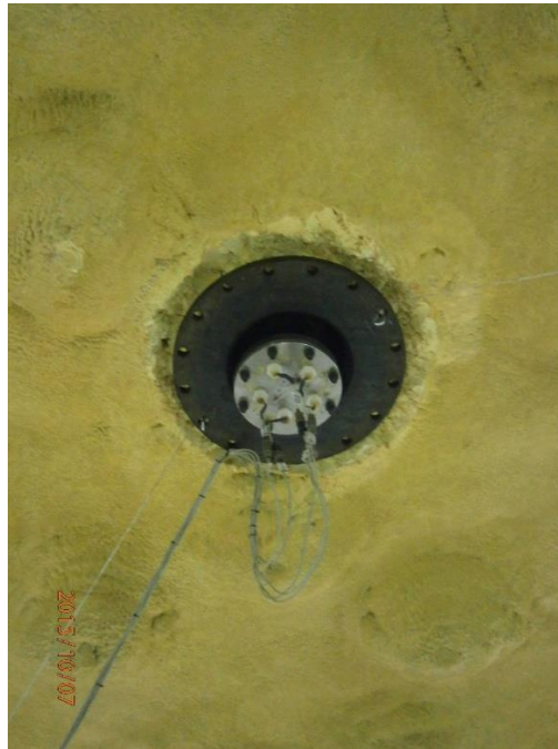
Foto 3. Penetración para lectura de presión E19N2 en la cava
