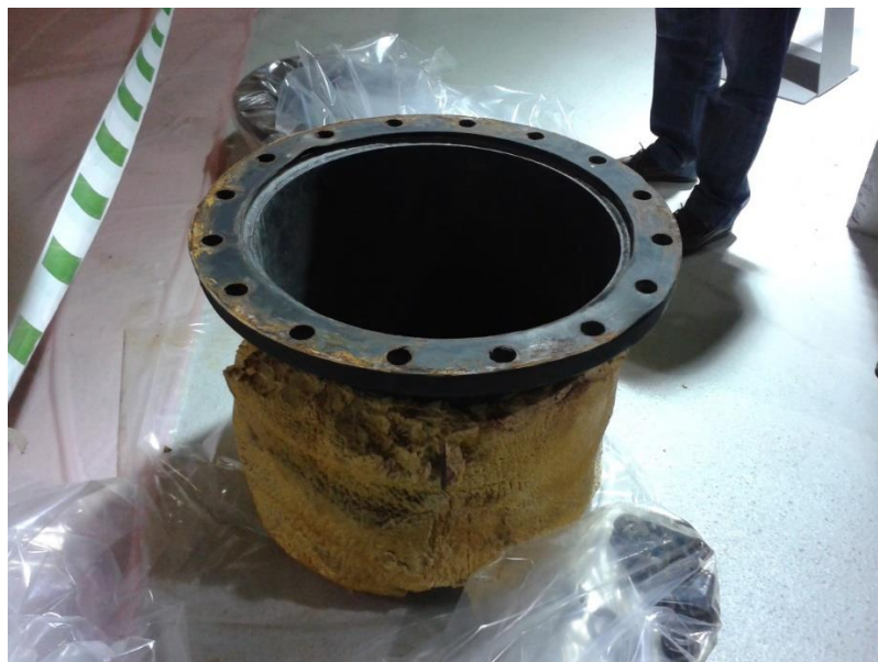
Foto 6. Tapones de las penetraciones de la cava.
