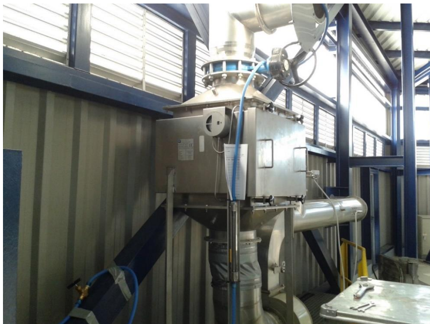
Foto 14. Sistema fijo de ventilación, filtración y descarga controlada con filtros HEPA., blindaje y disposición de sistema de confinamiento.
