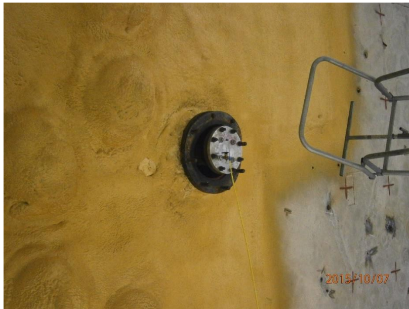
Foto 1. Penetración de instrumentación de temperatura E14N11 en la cava
