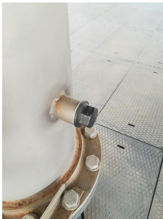
Foto 12. Tapón roscado macho de 1" de PVC a sustituir.
