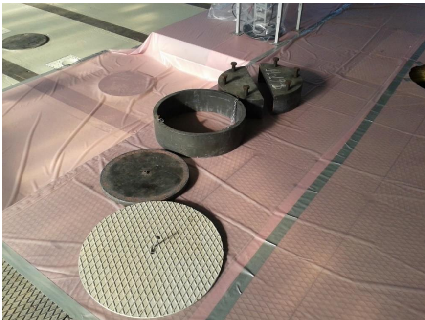
Foto 10. Tapas y bridas de las penetraciones de instrumentación de temperatura de la losa 57.80.
