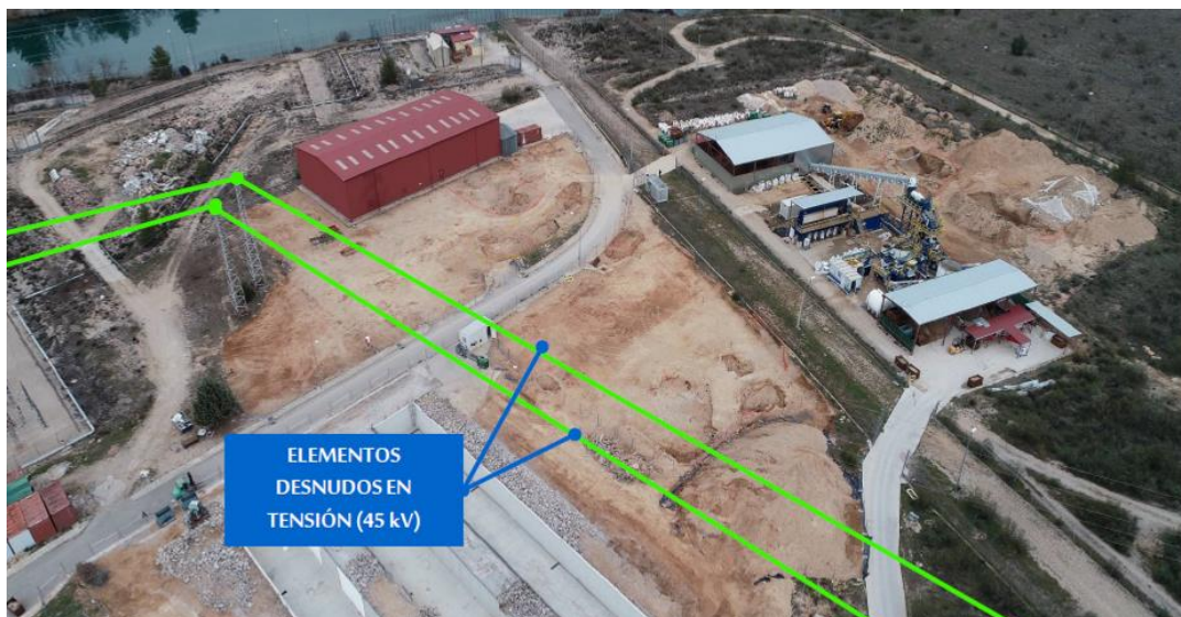
Figura 14. Líneas aéreas en tensión
