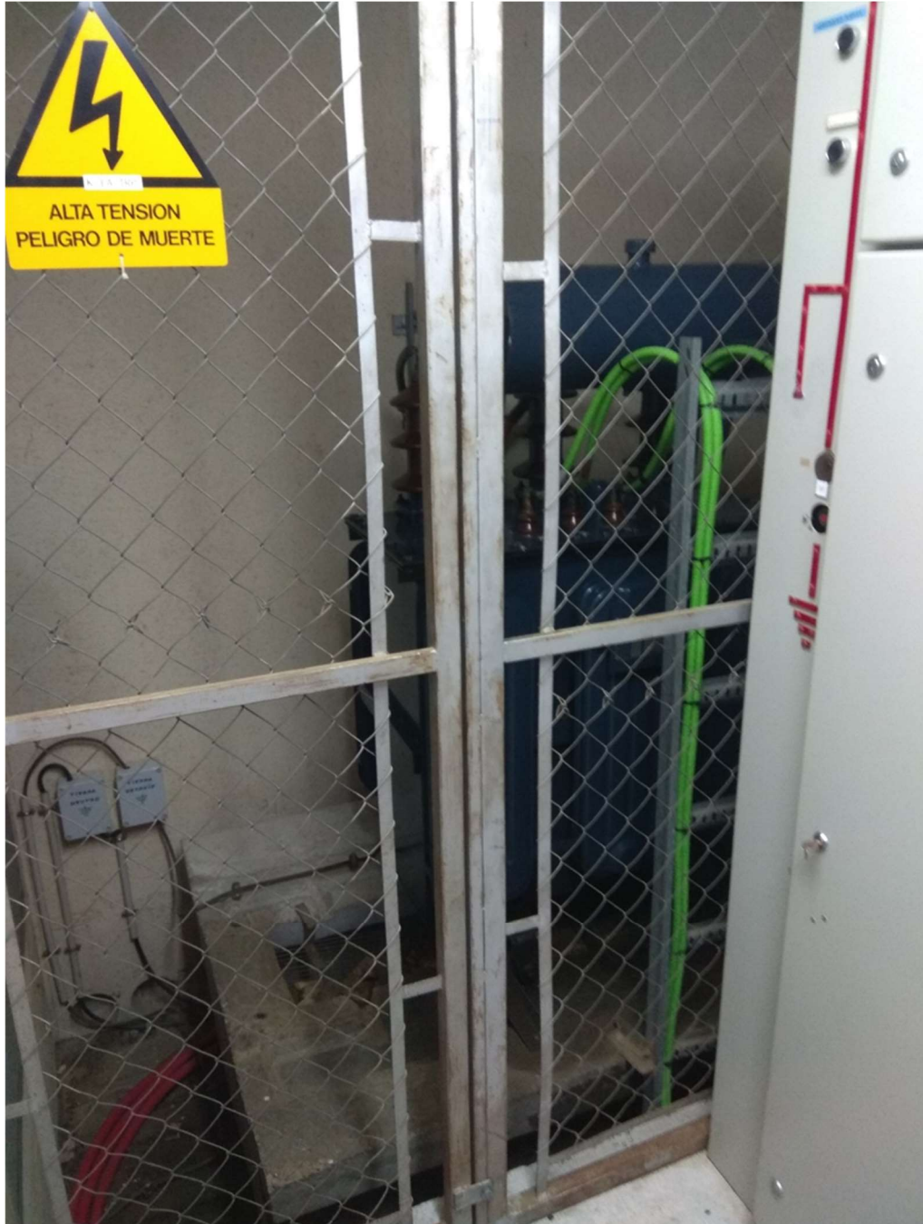
FOTOGRAFÍA N.º 5 Transformador de Potencia K-EA-TRP.
