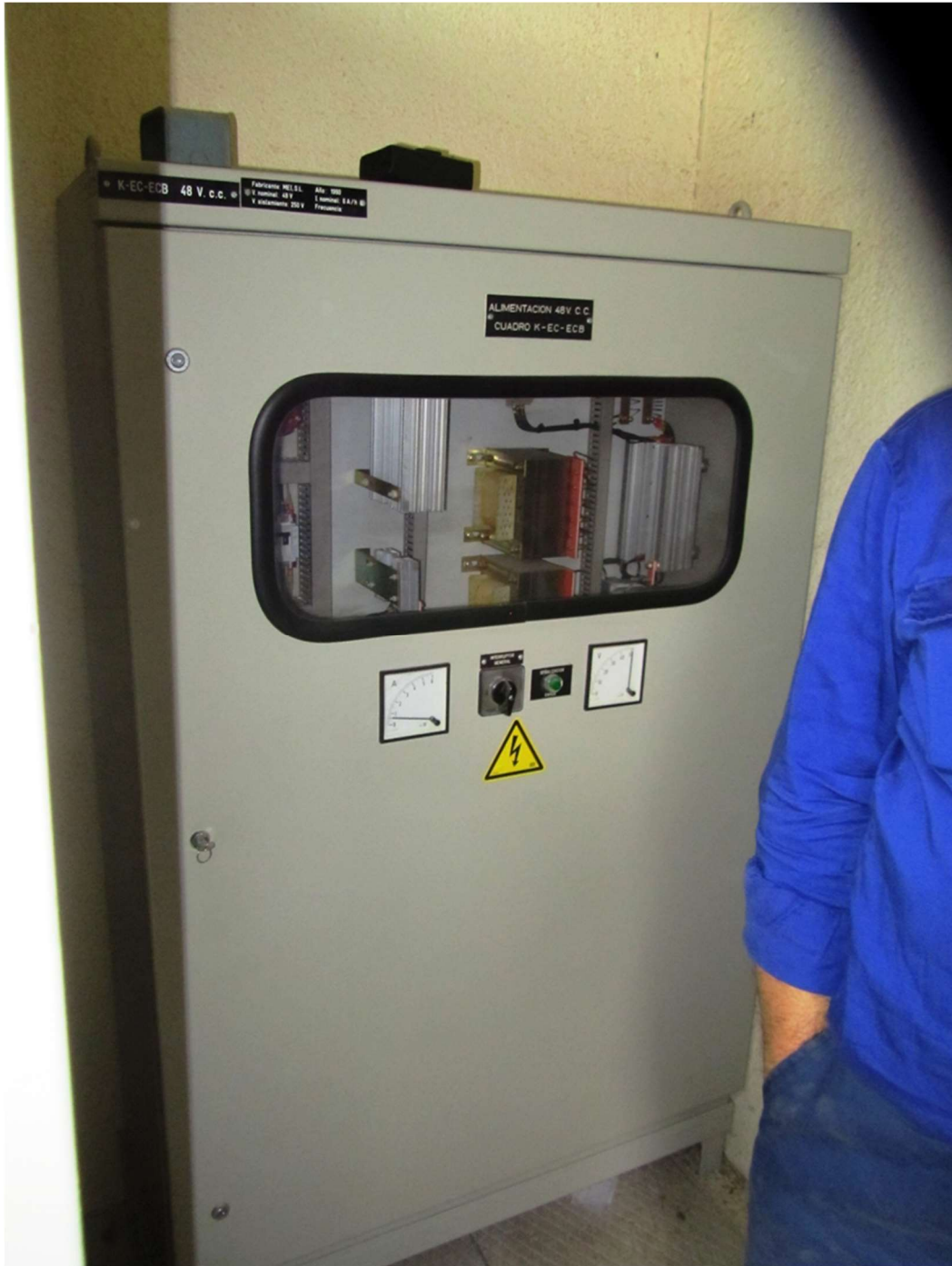
FOTOGRAFÍA N.º 8 Cuadro Tensión de Control 48 Vcc K-EC-ECB
