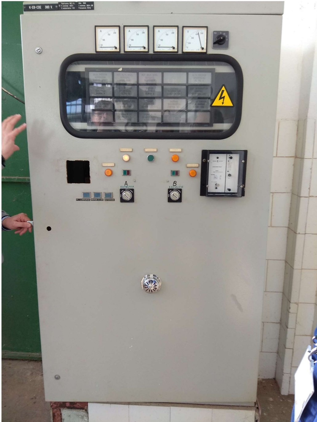
FOTOGRAFÍA N.º 10 Cuadro Distribución Local Casa de Bombas K-EB-CDE.
