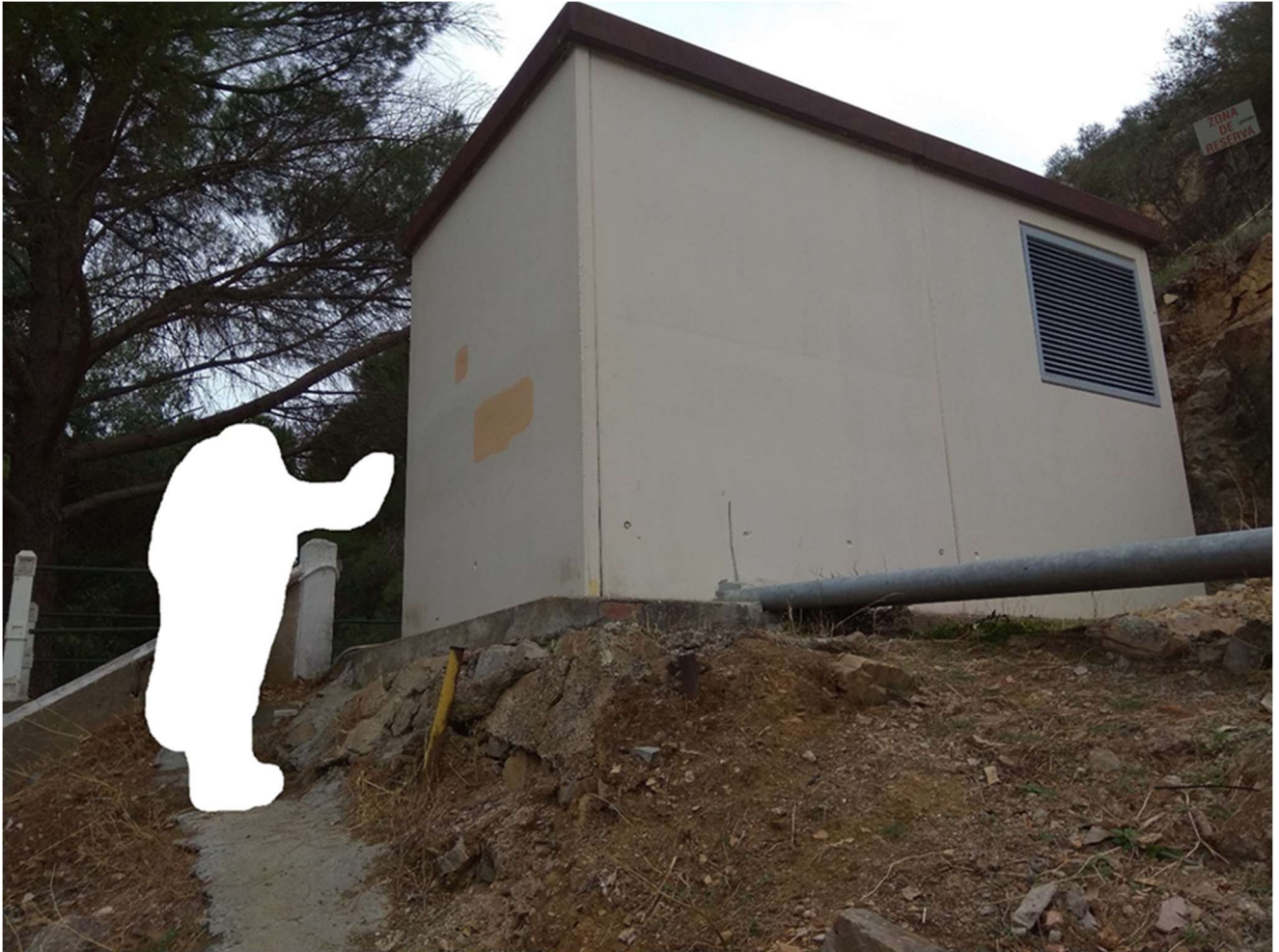
FOTOGRAFÍA N.º 4 Centro de Transformación Casa de Bombas. Esquina Sureste
