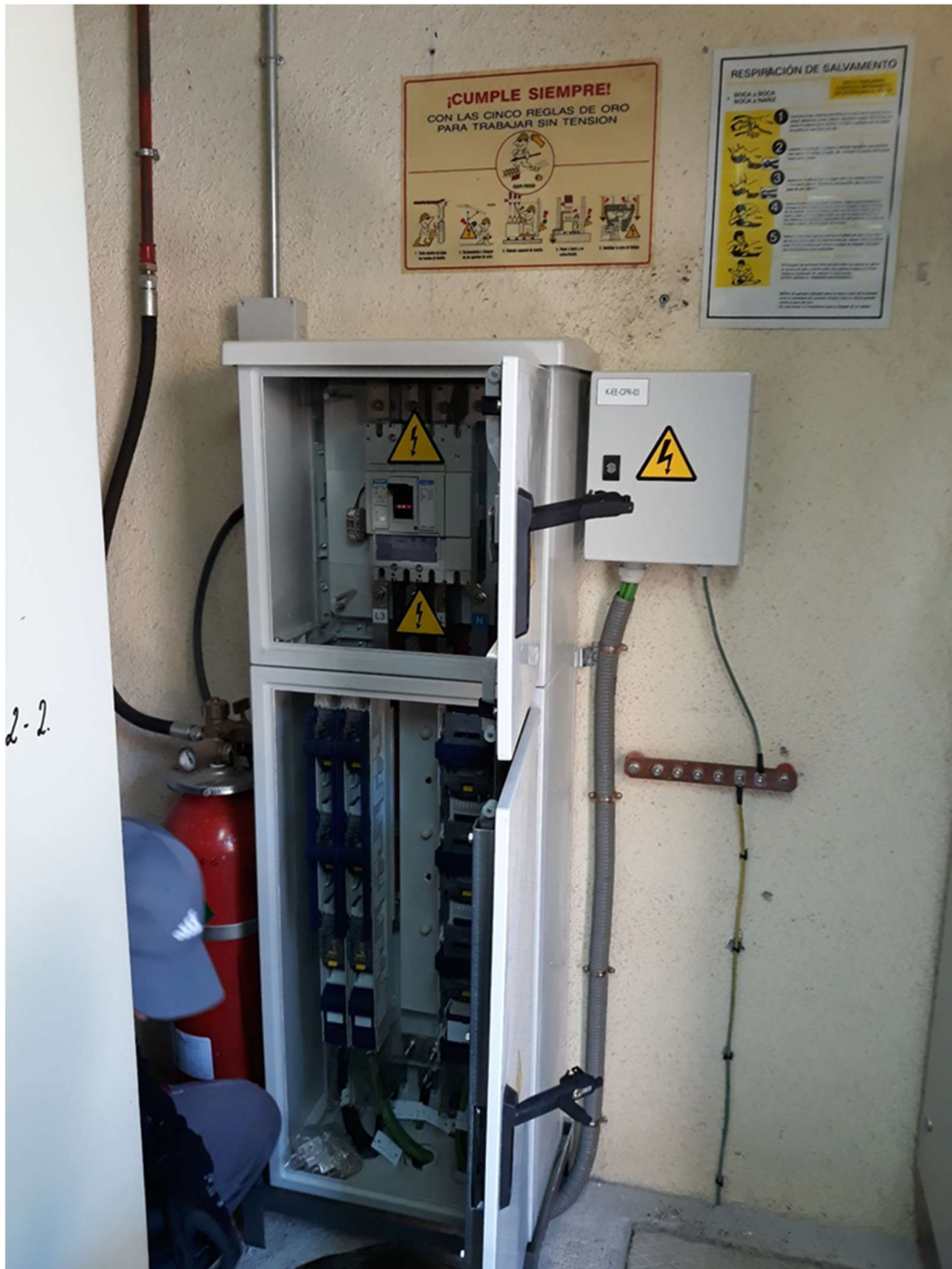
FOTOGRAFÍA N.º 7 Cuadro General de Baja Tensión K-EE-CBT01
