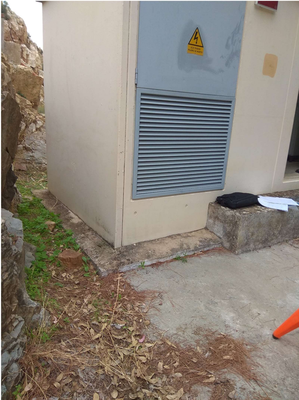
FOTOGRAFÍA N.º 3 Centro de Transformación Casa de Bombas. Esquina Noroeste.
