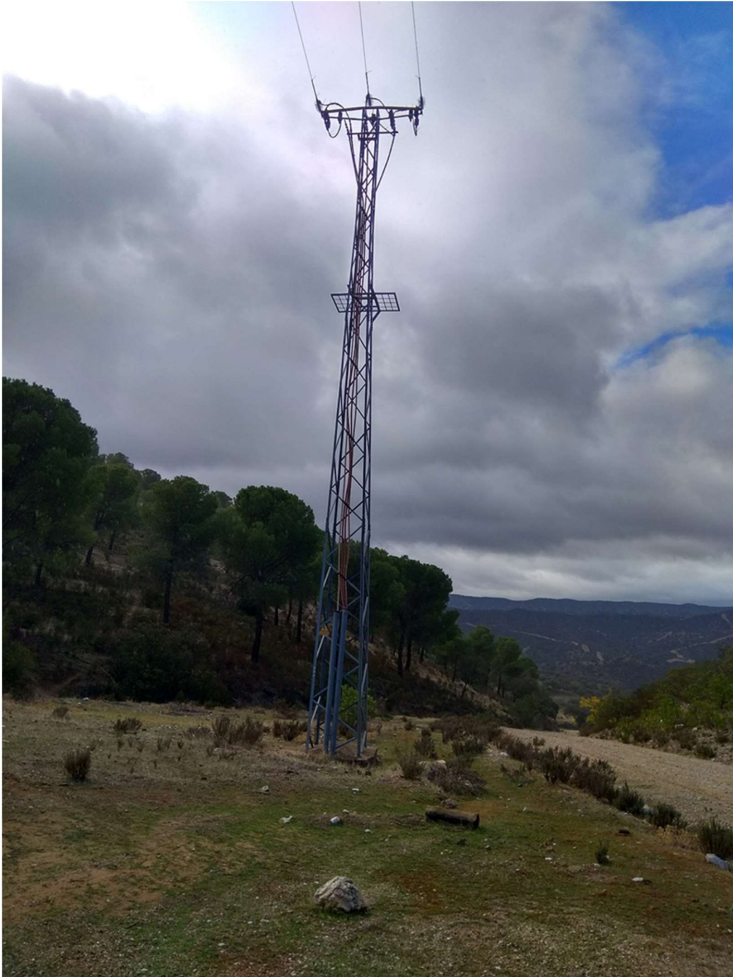
FOTOGRAFÍA N° 1 Apoyo paso de línea MT aérea a enterrada
