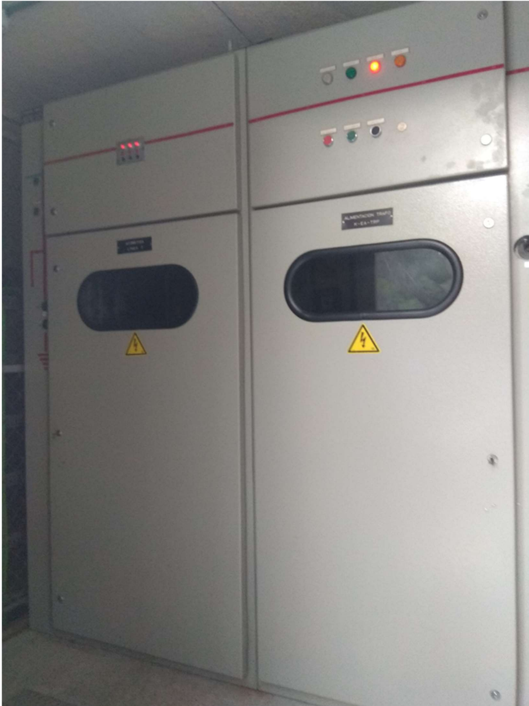
FOTOGRAFÍA N.º 6 Cabinas de MT K-EA-CAT.
