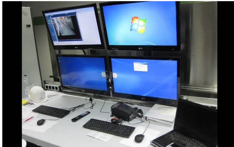
Figura 30.- Sala control EAD
