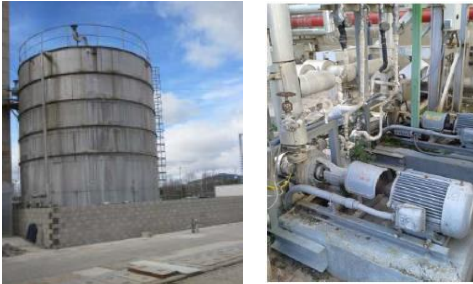
Figura 11. Tanque de control del vertido FH-20* y bombas DW-2A/B
