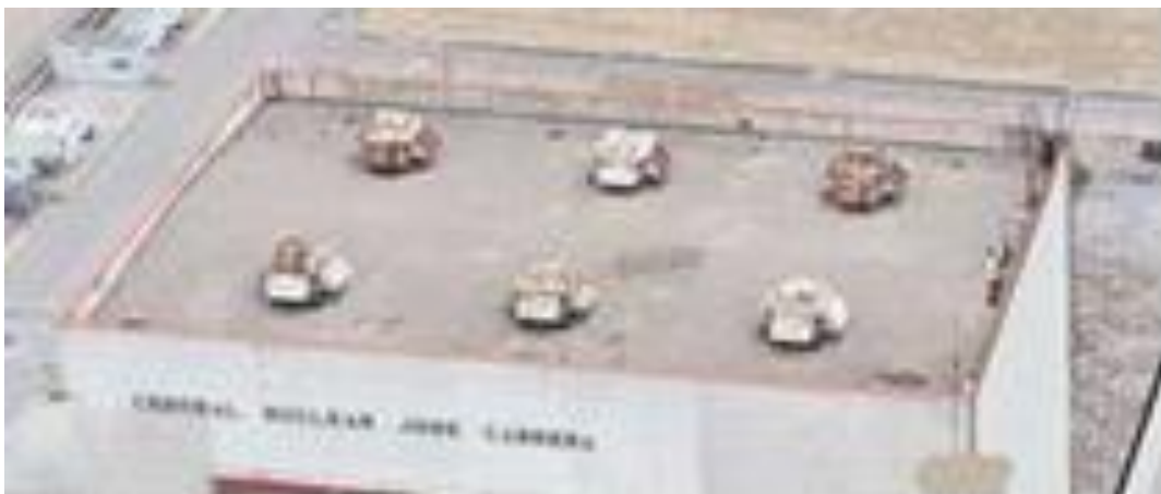
Figura 53.- Extractores en Cubierta
