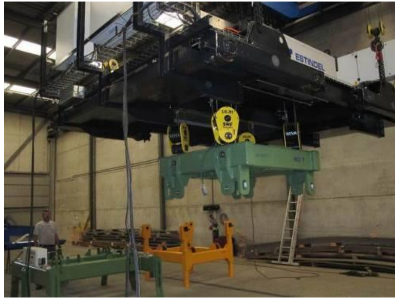
Figura 21.- Carro del Puente grúa del EAD y bastidor de enganche
