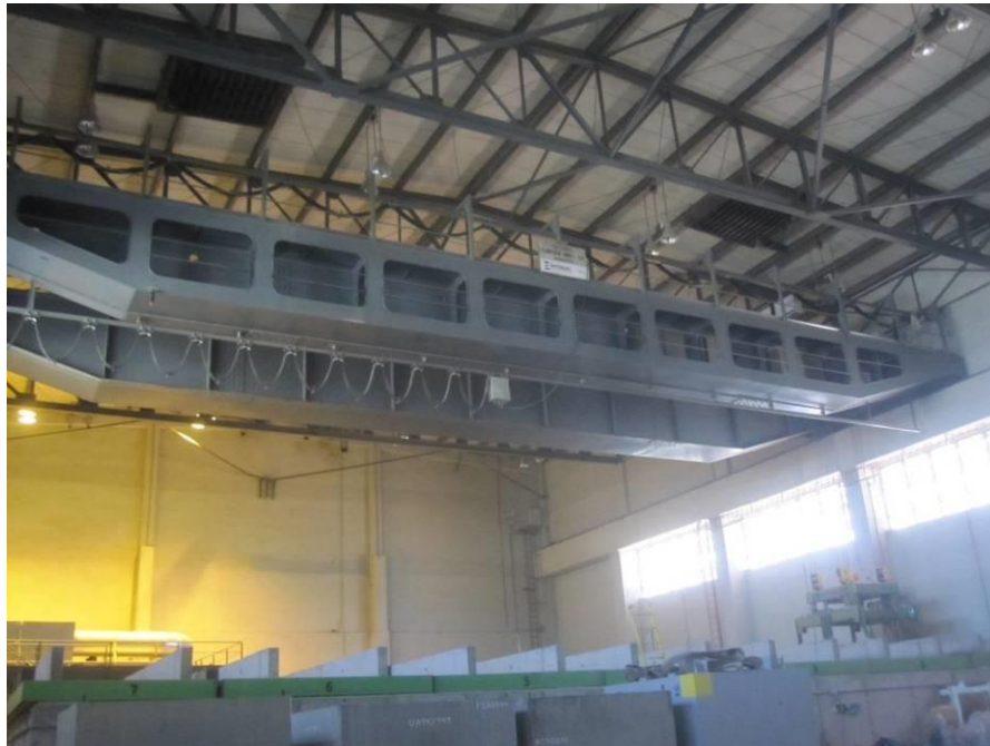
Figura 59.- Puente Grúa EAD en Planta de Operaciones
