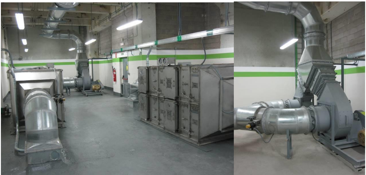
Figura 7. Sistema ventilación EAD. Ventiladores y cajón de filtros.
