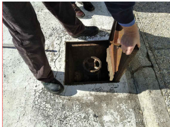
F-8 Detalle de arqueta y válvula existentes en entrada de tubería actual a Hangar
