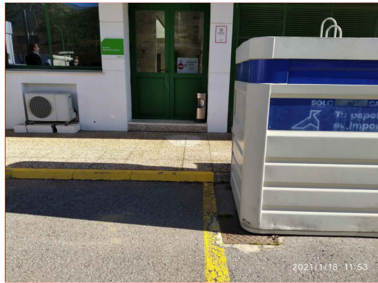
F-1 Zona de entrada de tubería a BIE de Edificio de Archivo y Servicios sociales
