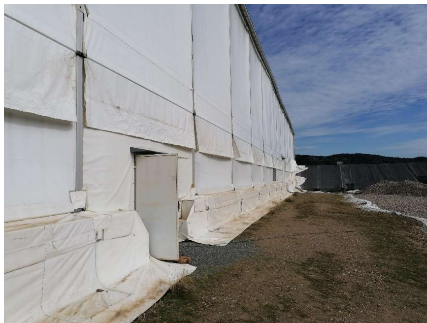
Foto 4. Actual cara sur de la cubierta de 25m, desde el fondo del vaso.
