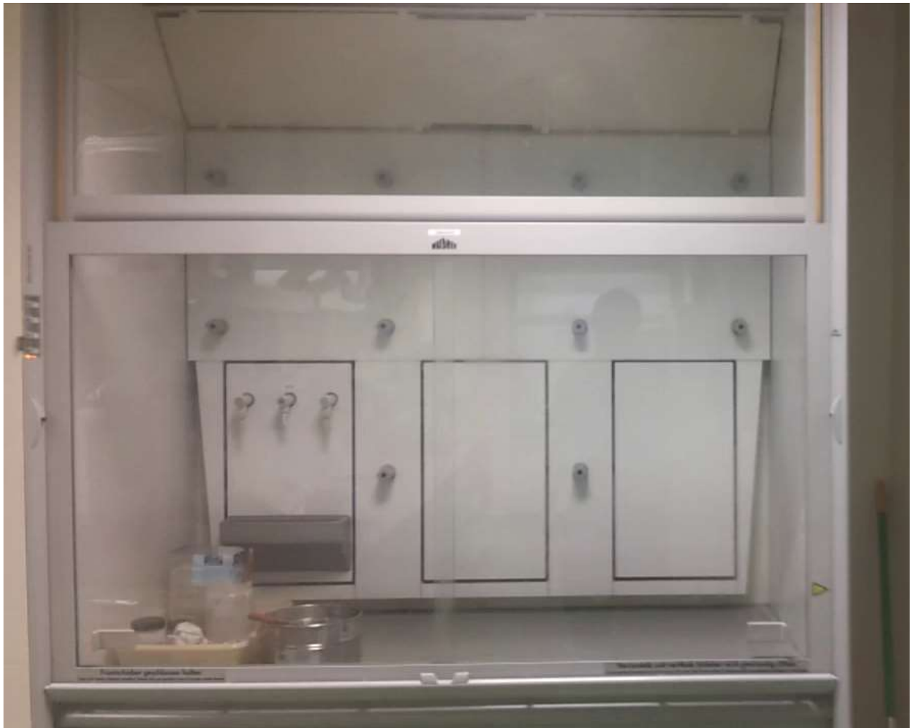
A- 2, Área de trabajo de vitrinas del edificio Auxiliar de Acondicionamiento.
