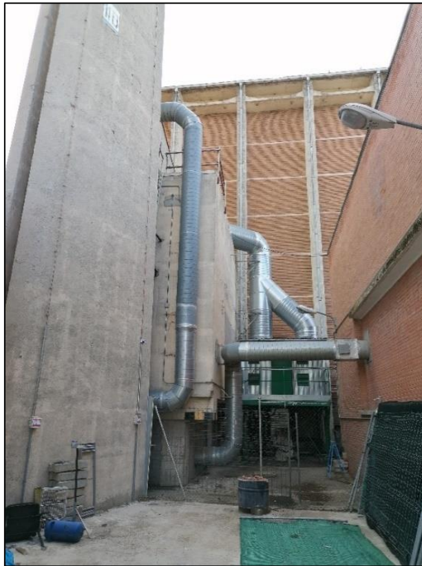
Figura 3. E-11 Torre y sistema de ventilación del E-11
