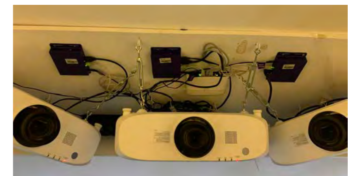
Proyectors (actualmente en Villar de Cañas)
