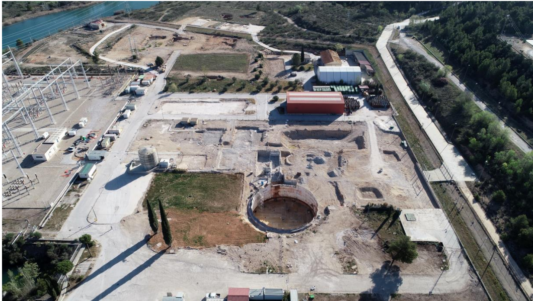
Figura 3. Estado de la instalación CNJC (2023)
