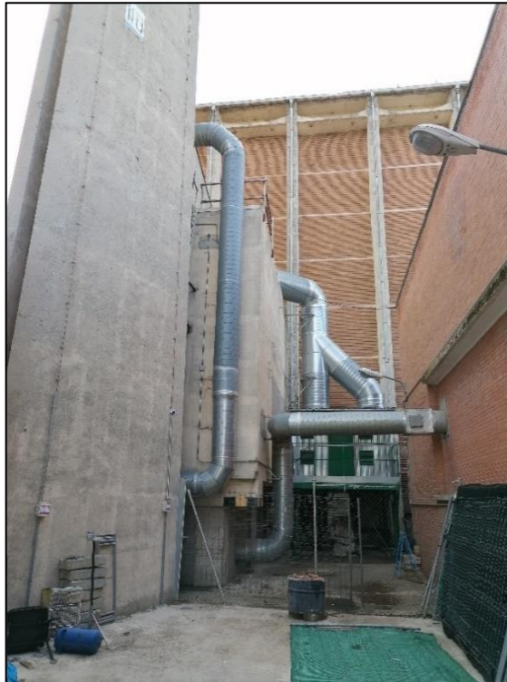
Figura 2. E-11 Torre y sistema de ventilación del E-11
