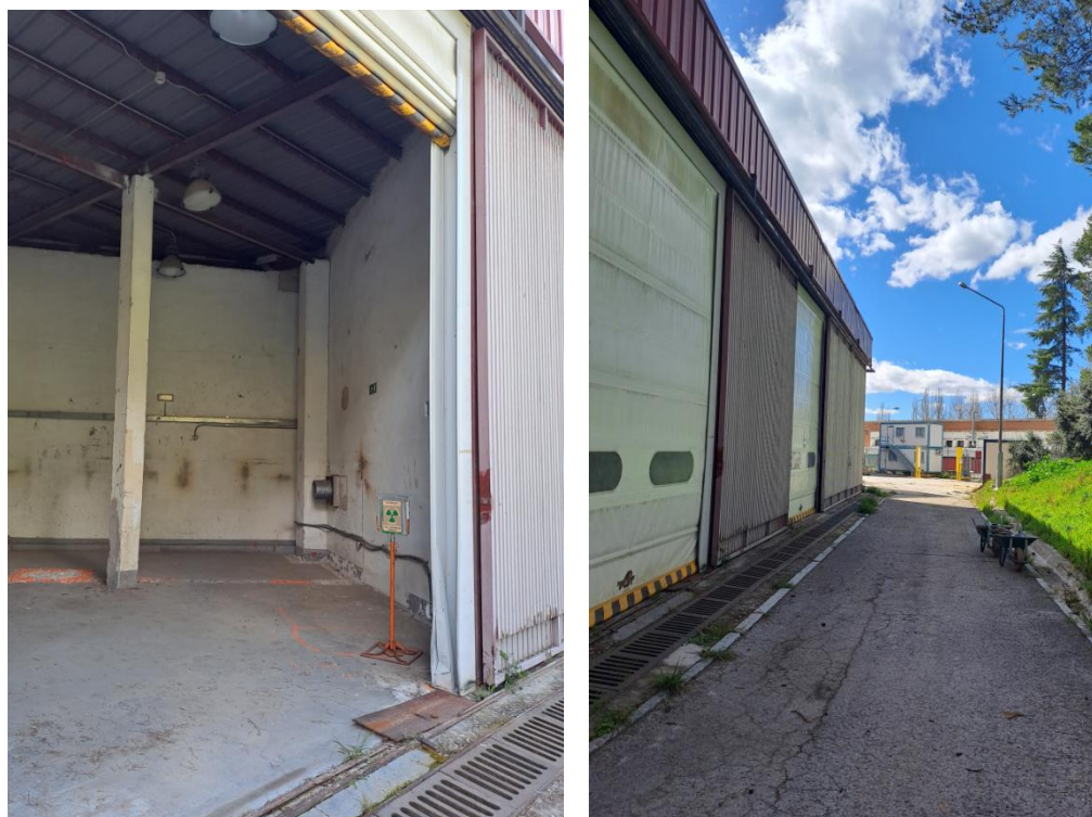
Figura 10. Fotos de exterior del local D del edificio 64, del vial, canaleta y puertas
