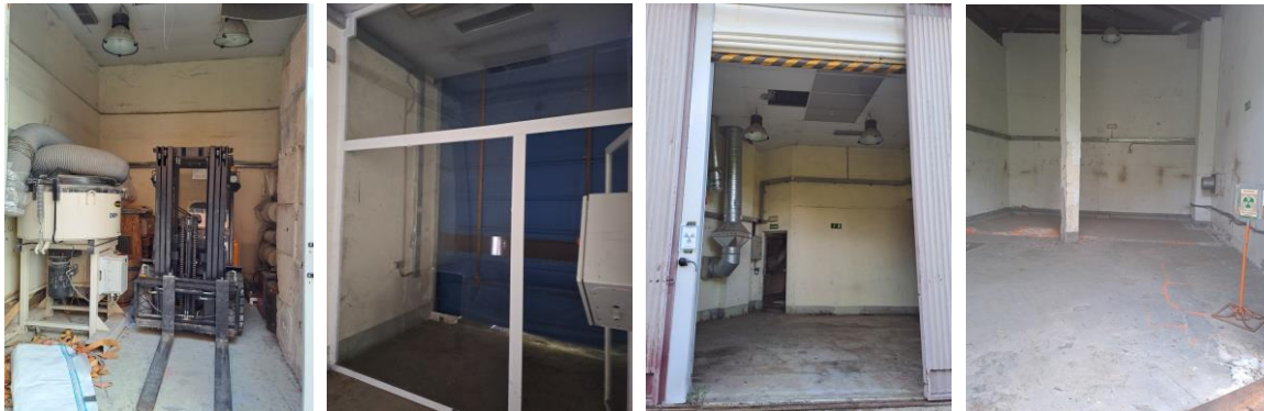
Figura 7. Estado actual del Edificio E-64 (de izquierda a derecha, locales A, B, C y D).
