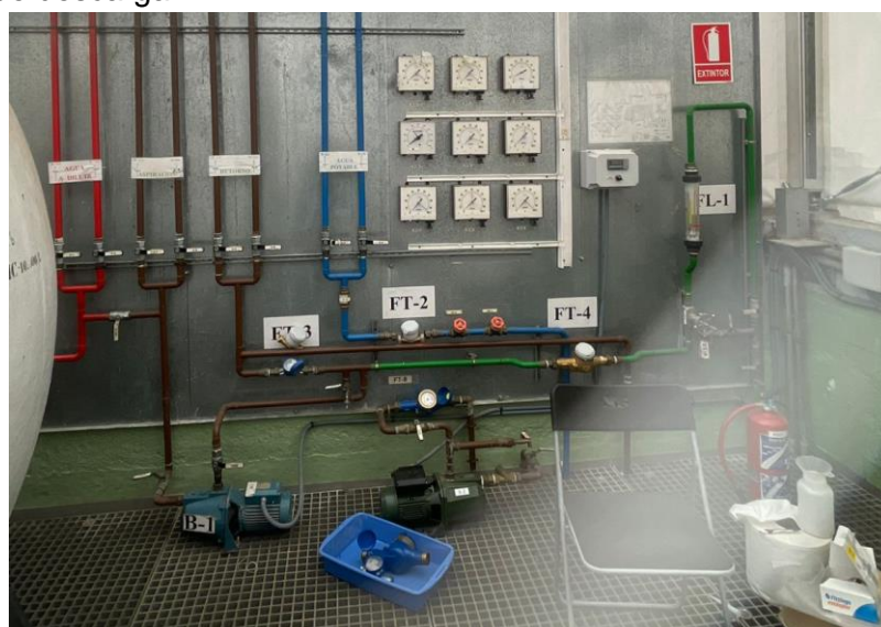
Figura 9. Bombas de la instalación STEL (fotografía)
