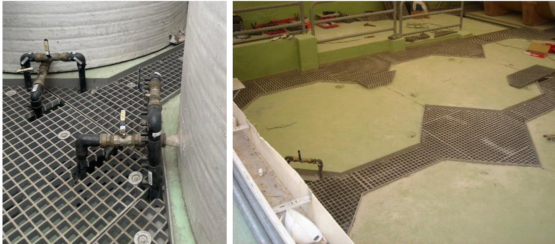
Figura 10. Detalle de la rejilla tramex de la instalación STEL.
