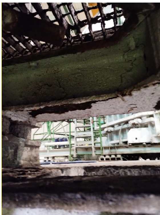
Ilustración 7. Zona por reforzar.
