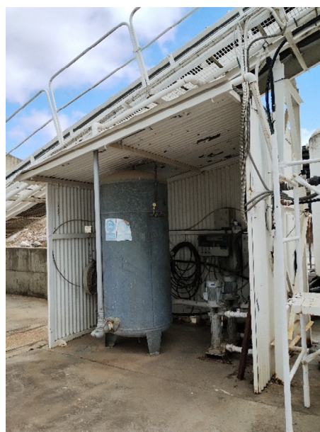
Ilustración 11. Caseta de bombas
