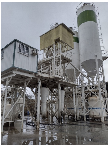
Ilustración 10. Planta de hormigón
