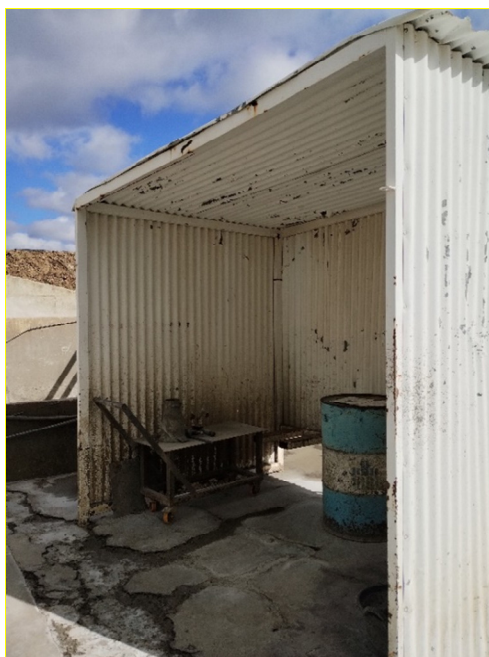
Ilustración 8. Caseta de ensayos
