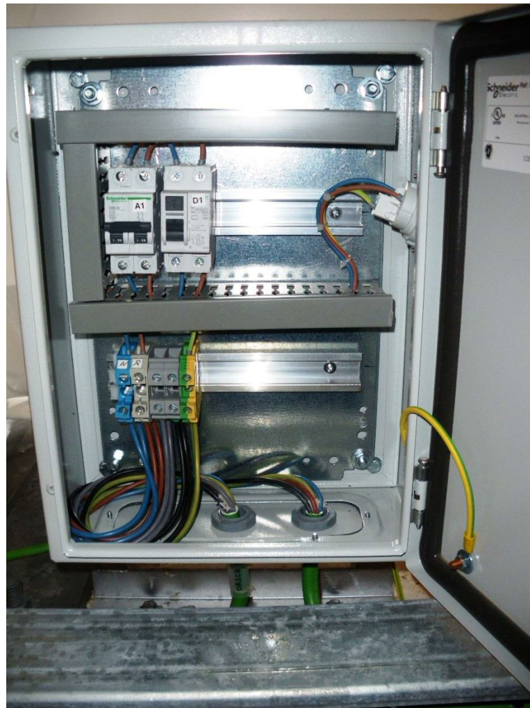
Figura 13 Interior Caja de distribución de alumbrado descolgado instalada sobre zapata
