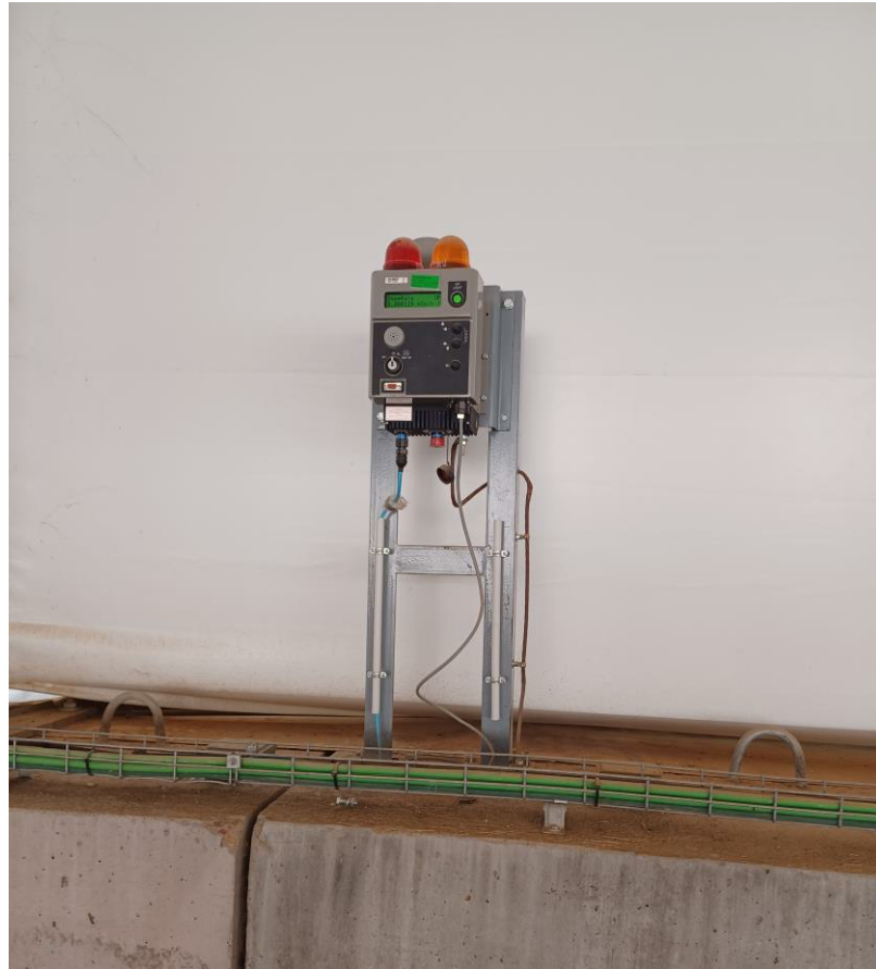
Figura 21 Instalación Monitor de Radiación sobre zapata
