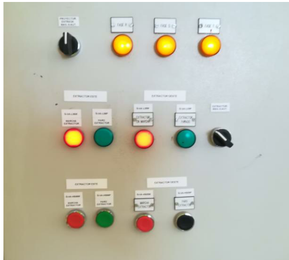
Figura 5 Maniobra extractores Ñ-VA-EX05/06 existentes desde cuadro Ñ-EE-CDE04
