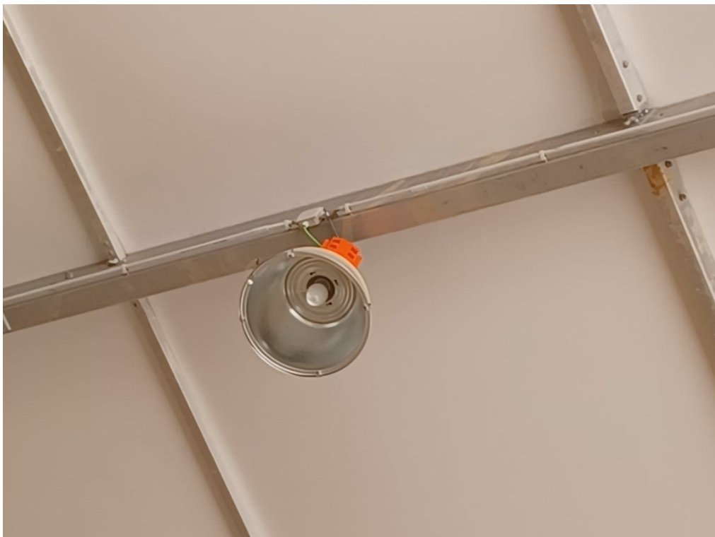
Figura 12 Detalle instalación de campana a perfil metálico del techo de la cubierta
