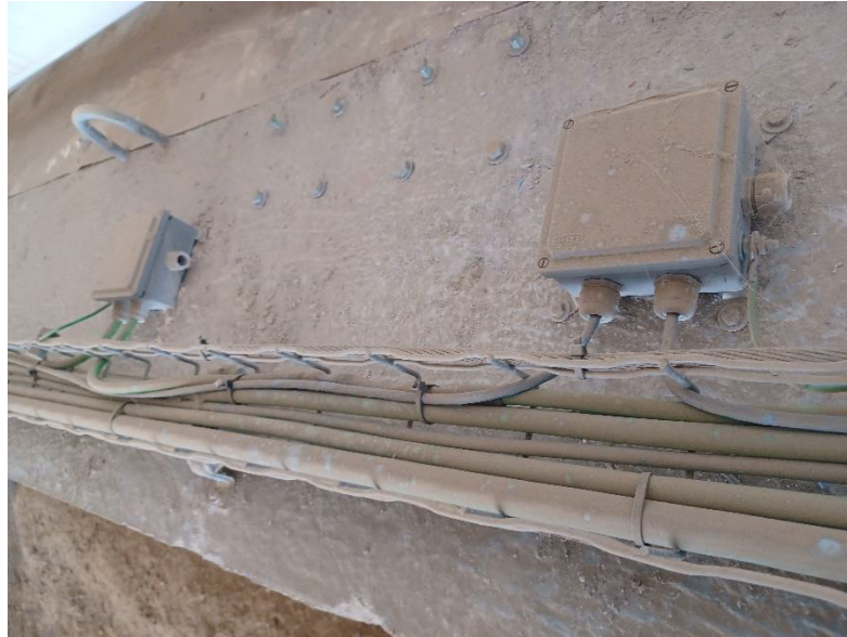
Figura 22 Preinstalación de una posición de monitores equipada
