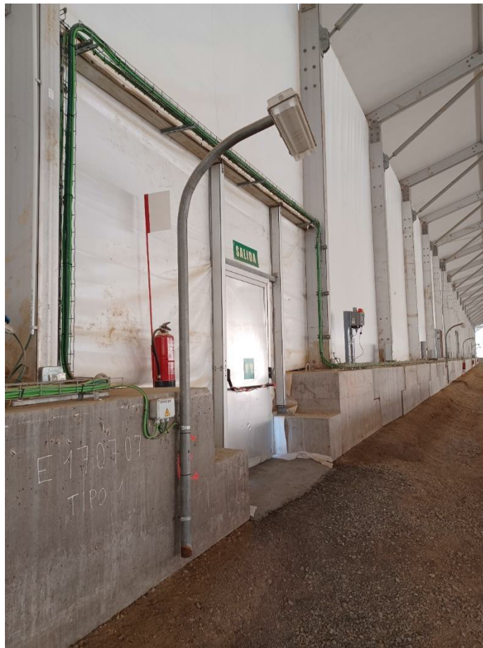
Figura 16 Luminarias de emergencia que hay que reemplazar (8)
