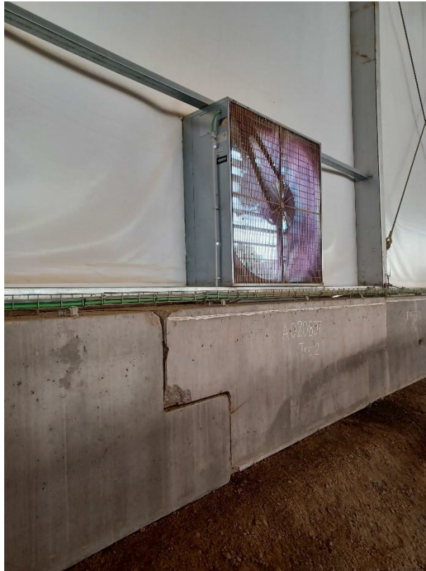
Figura 20 Extractor existente lateral norte cubierta C20
