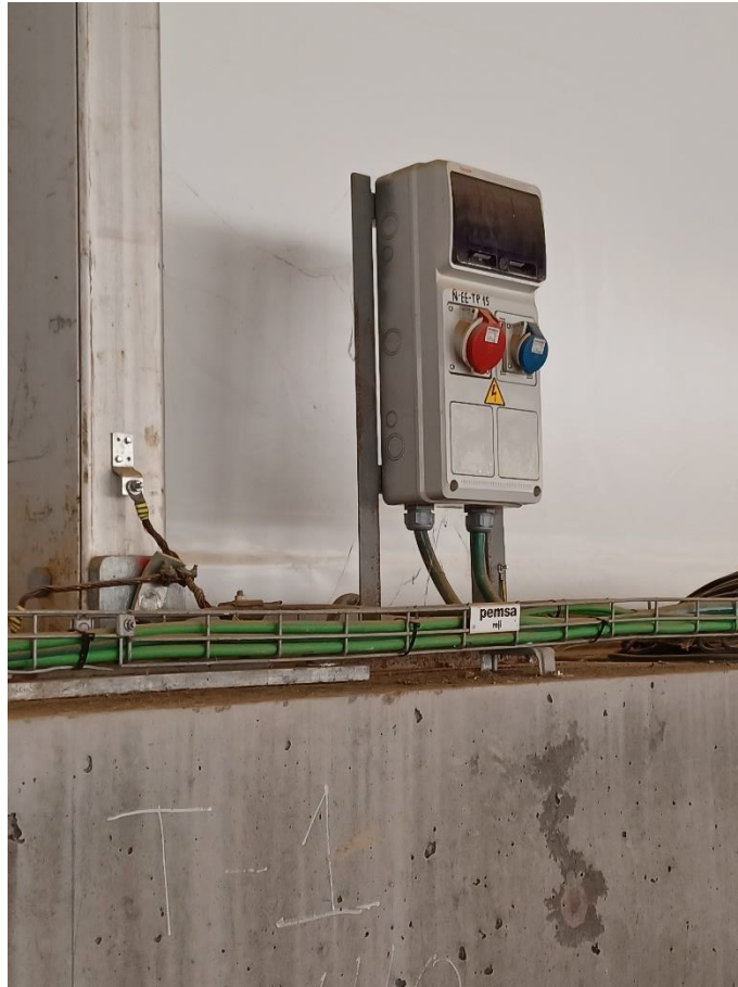
Figura 19 Detalle de instalación de caja de tomas de potencia
