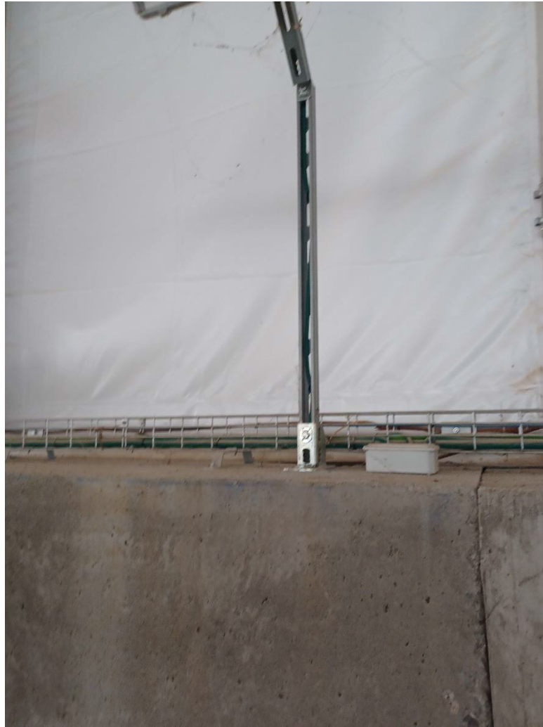
Figura 18 Detalle instalación luminaria de emergencia celda 30
