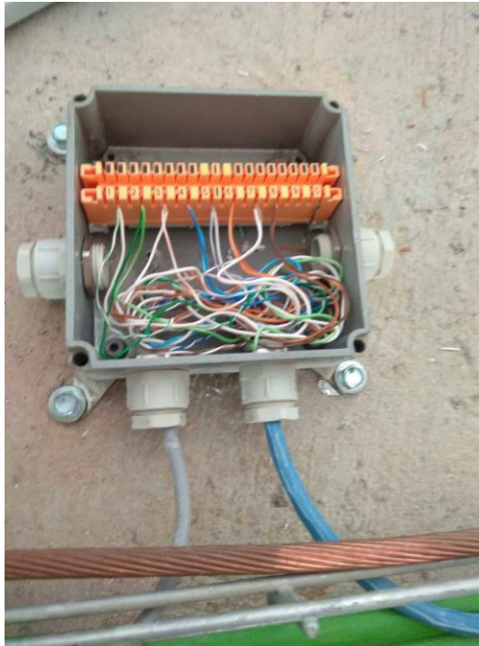
Figura 24 Caja de conexión de datos posiciones de monitor
