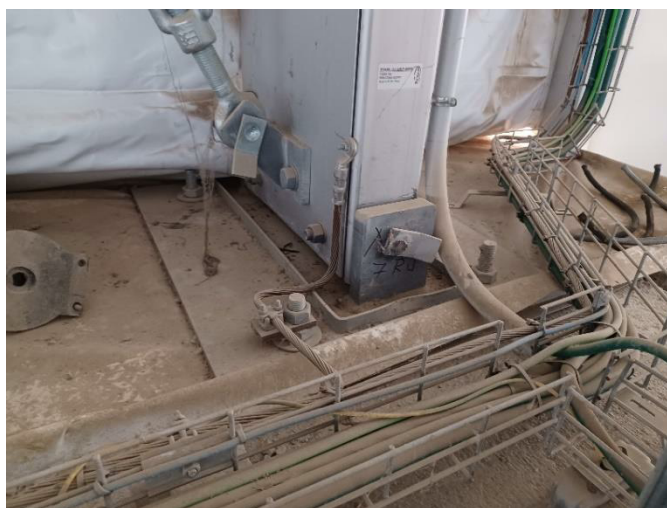
Figura 27 Detalle unión equipotencial del pórtico con la red de tierras interior
