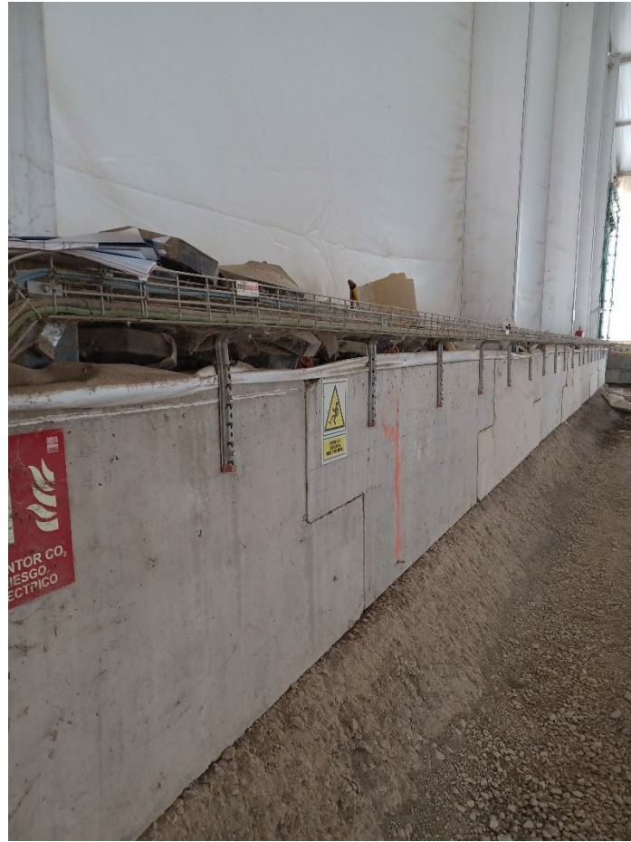
Figura 10 Instalación bandeja por el lateral interior de la zapata para sortear obstáculos
