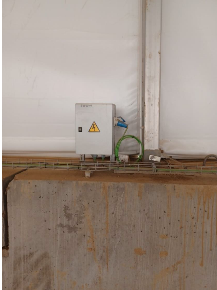
Figura 14 Caja de distribución de alumbrado descolgado instalada sobre zapata
