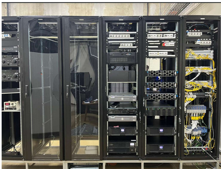
Fotografía 2. Armarios B-YC-TEL01, B-YA-ALC01/02/03/04/05
