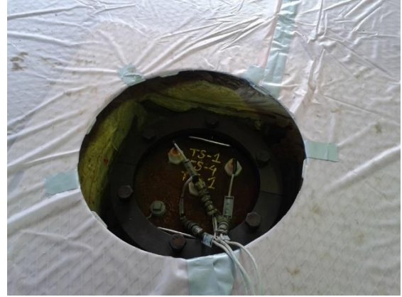
La penetración de instrumentación de temperatura F4M2.
