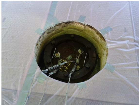
La penetración de instrumentación de temperatura F13M11.
