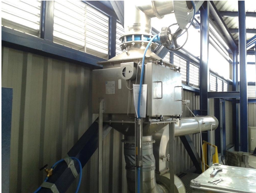
Sistema fijo de extracción de aire del cajón del reactor.
