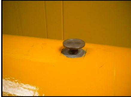
a. Tapones cáncamo tubo que se encuentran en la generatriz superior del cilindro.
