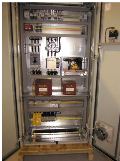
Fotografía 5: Vista interior del armario de distribución
