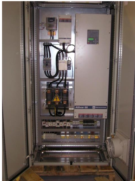
Fotografía 8: Vista interior del armario asociado a la elevación auxiliar
