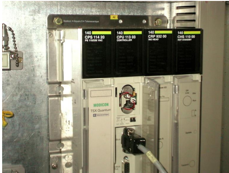
Fotografía 12: Ejemplo conexionado entre módulos del sistema de control
