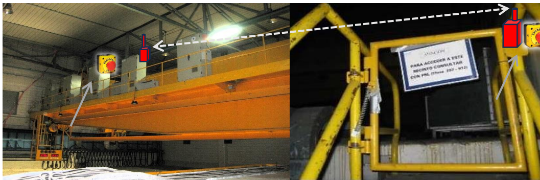
Fotografías 26 y 27: Localización de pulsadores de emergencia en la grúa
