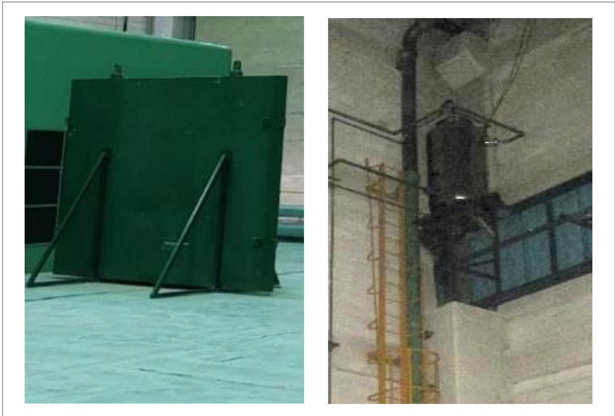
Figura 24: Placas de blindaje (izquierda) y tanque pulmón sistema de refrigeración (derecha)
