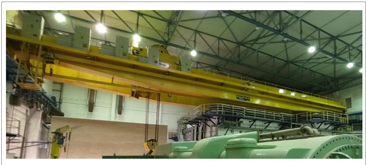
Figura 3: Puente grúa de la Planta de Operación de Turbina
