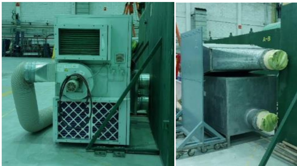
Figura 26: Munters y equipos de filtración existentes en POT
