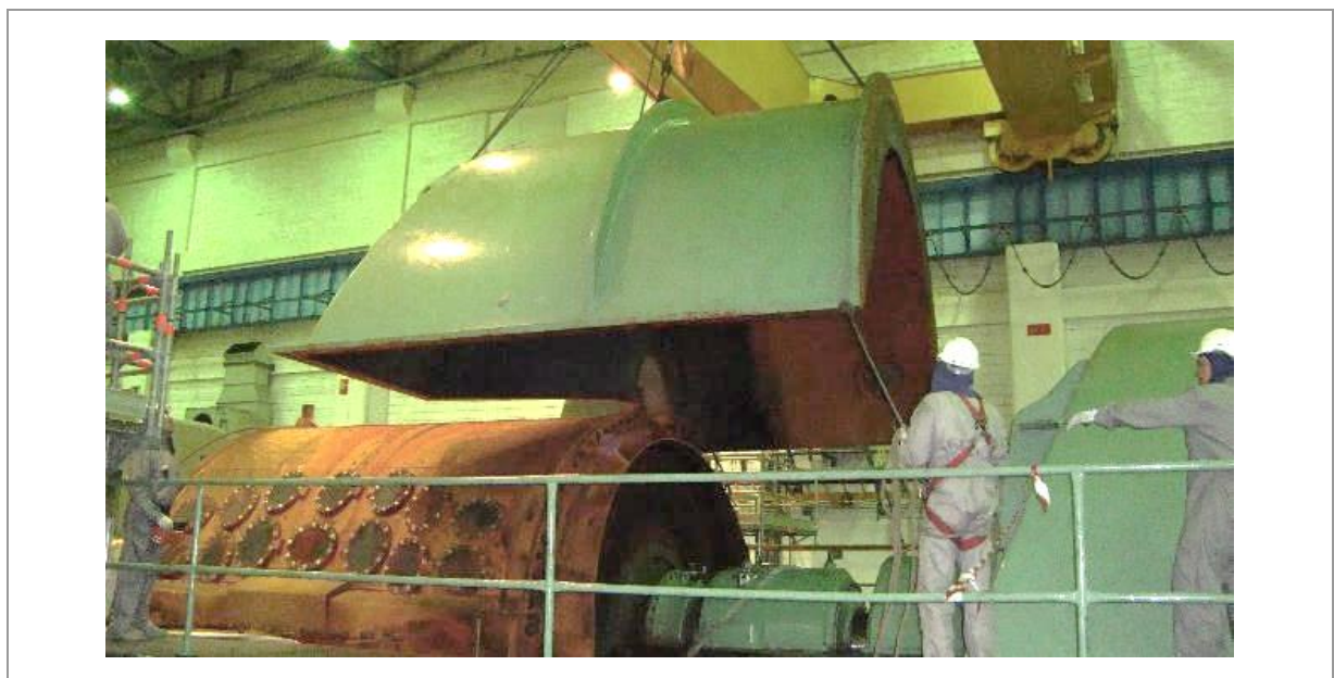
Figura 16: Foto carcasa exterior superior turbina de baja
