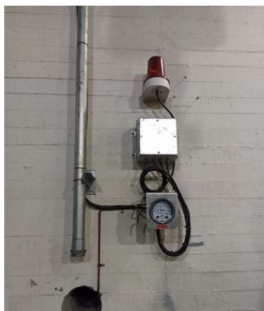
Figura 4.4-2: Actual lazo de medida de DP del edificio auxiliar de procesado (EAP). Zona D2.07.00, elevación 518,00)
