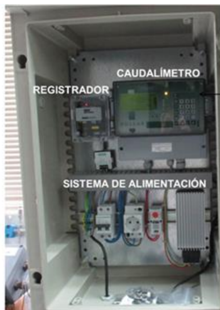
Figura 2. Armario del SAD de la estación de la Celda 30 (SDC30)
