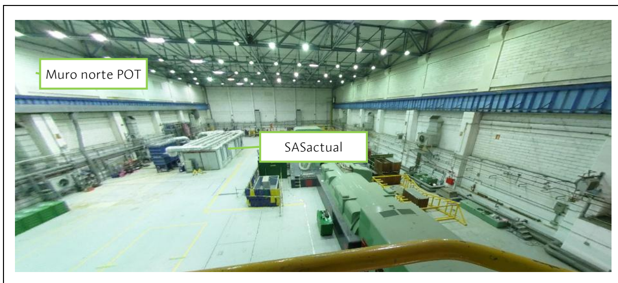
Figura 7: Vista aérea interior de la Planta de Operación de Turbina.
