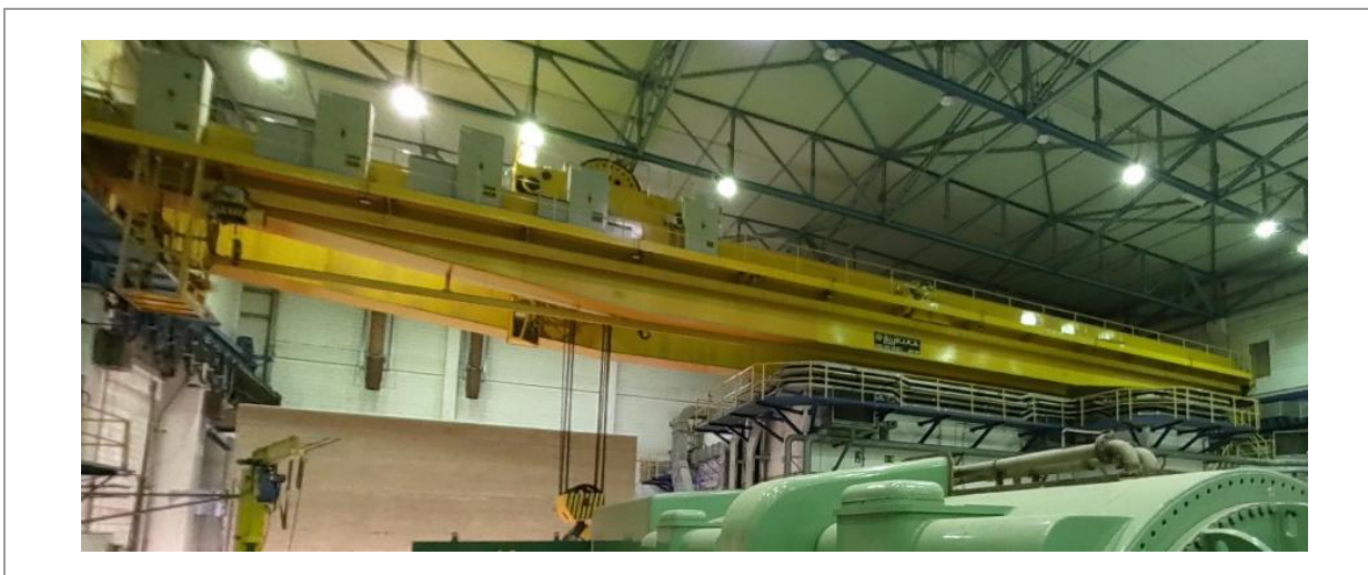
Figura 3: Puente grúa de 150 T.
