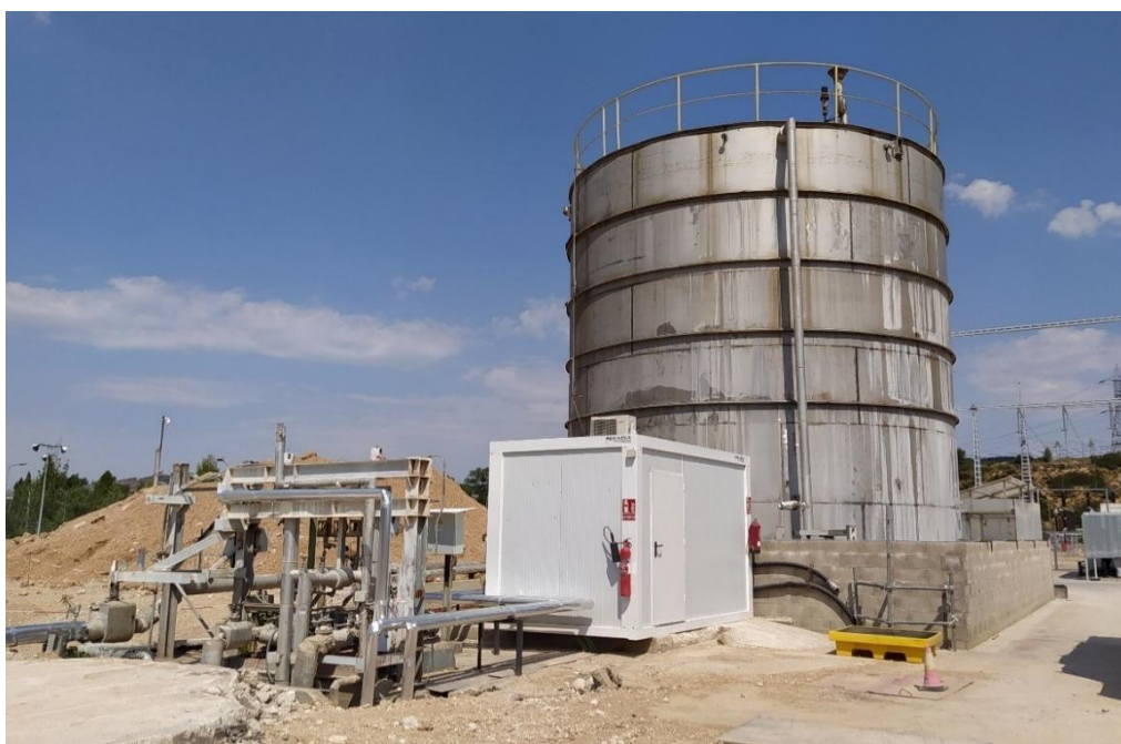
Ilustración 4 Sistema de Tratamiento de Efluentes Líquidos FH-20*
